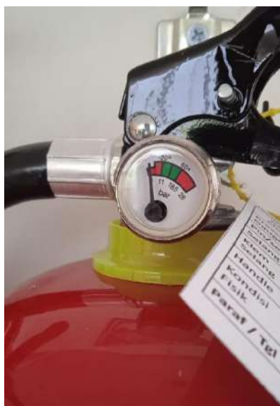
APAR Ruang Kuliah 3 lantai 3
