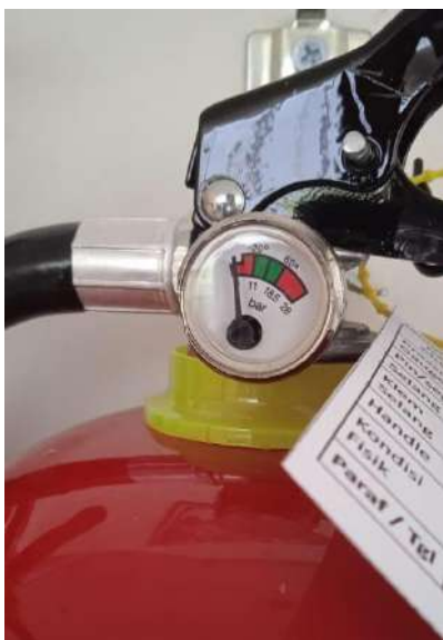
APAR Ruang Kuliah 3 lantai 3
