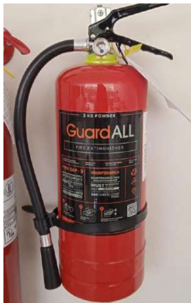
APAR Ruang 2.7 Lab Fisika
