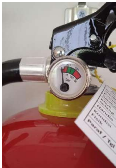
APAR Ruang Kuliah 3 lantai 3
