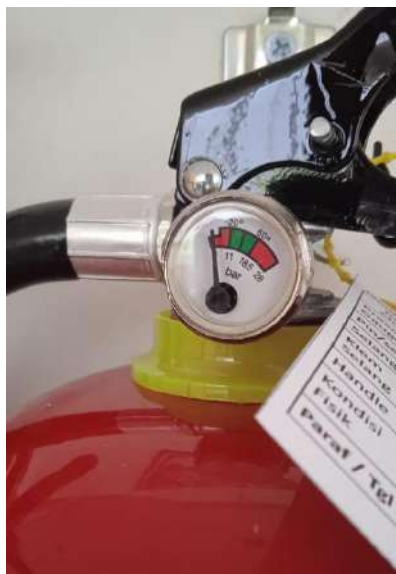
APAR Ruang Kuliah 3 lantai 3
