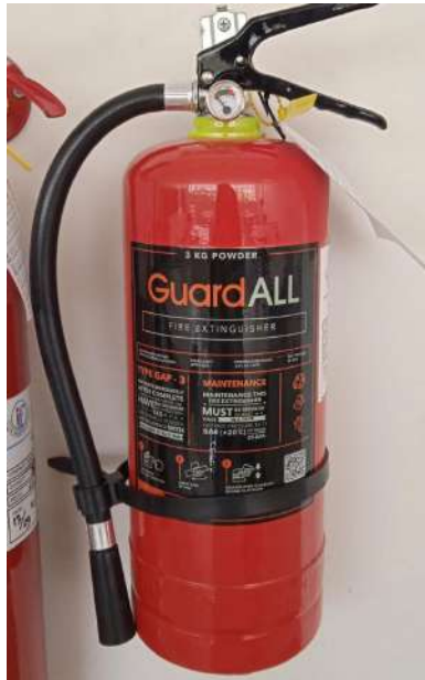
APAR Ruang 2.7 Lab Fisika
