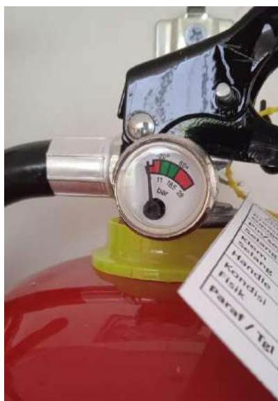
APAR Ruang Kuliah 3 lantai 3
